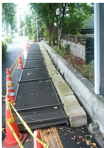
昨年8月方南通り沿いのブロック塀が豪雨と強風で倒壊。通行人がいなかったため被害はなし。地震であれば危ないところでした
